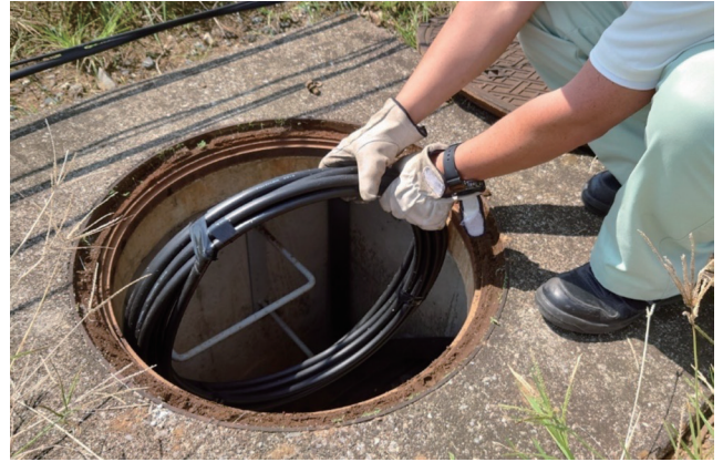
図9 細径クラッド光ファイバを用いた1728心WTCのハンドホール収容の様子
