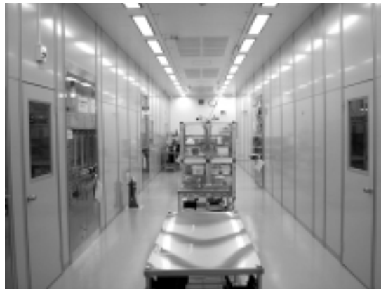
図1 新工場内クリーンルーム
