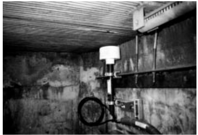
図6 GPSアンテナ設置状況 Appearance of GPS antenna
