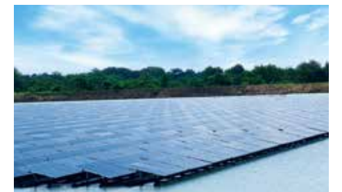
FETL社カビンブリ工場内のため池に設置された水上太陽光パネル
