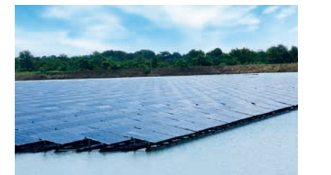
FETL社カビンプリ工場内のため池に設置された水上太陽光パネル
