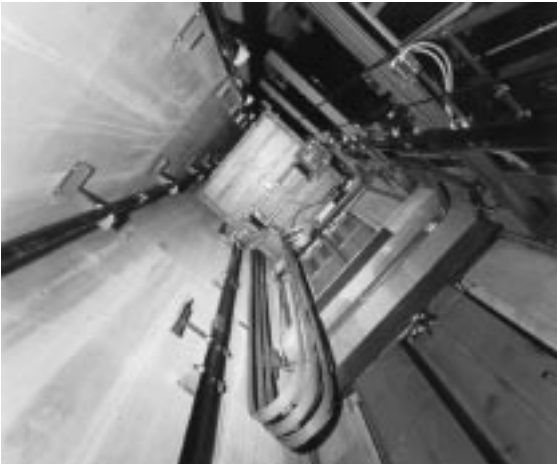
図4 エレベータケーブル
