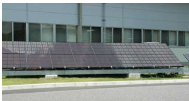
図 4 DSC パネルを用いた屋外試験の様子
