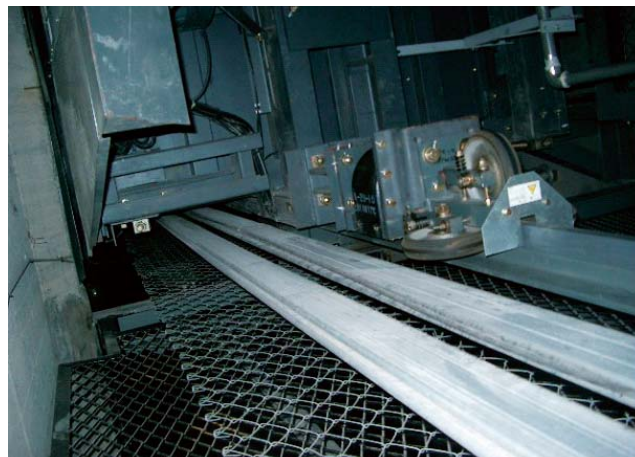
図2 エレベータケーブルの使用状況 Fig. 2. View of installed elevator cable.
