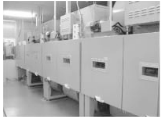
図3 乾燥ゾーンの外観図 Curing zone
