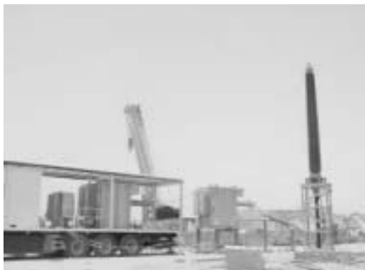
図13 竣工試験状況 Commissioning test
