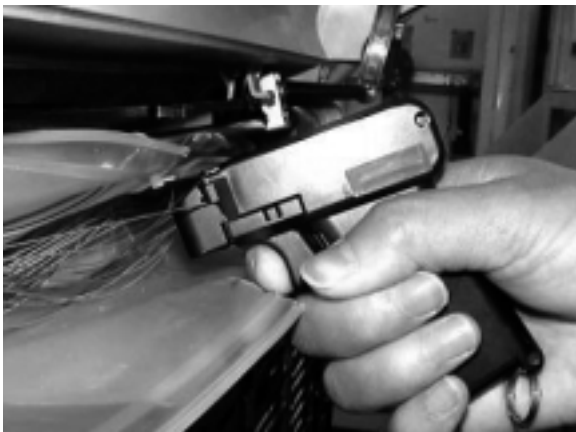
図7 クロージャ内での従来器による対照作業 Fig. 7. Identification with previous identifier in closure.
