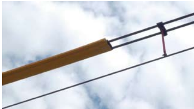
(b) き電吊架線への使用例
